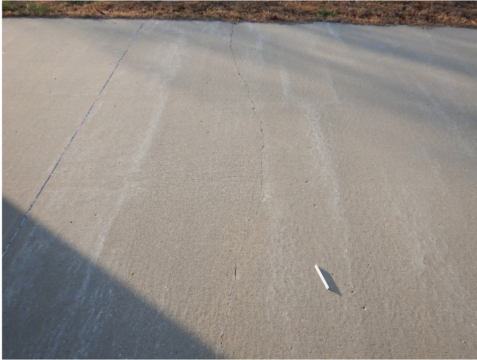
TH01AT-03. LTD Cracking (Sample Unit No. 01).
