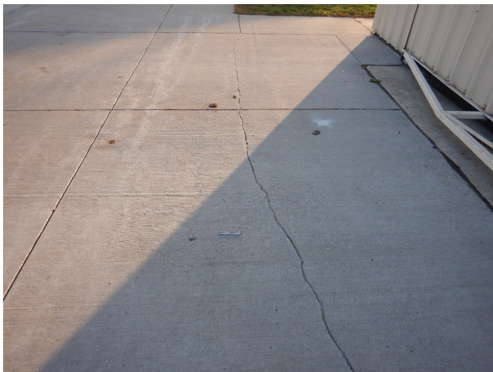
A01AT-01. LTD Cracking (Sample Unit No. 51).
