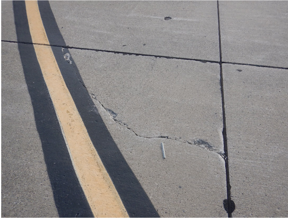
T03CA-01. Corner Break (Sample Unit No. 08).
