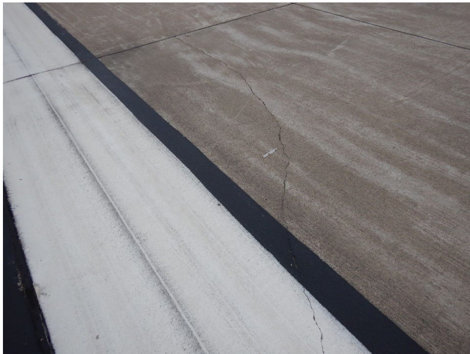
R03CN-02. LTD Cracking (Sample Unit No. 07).
