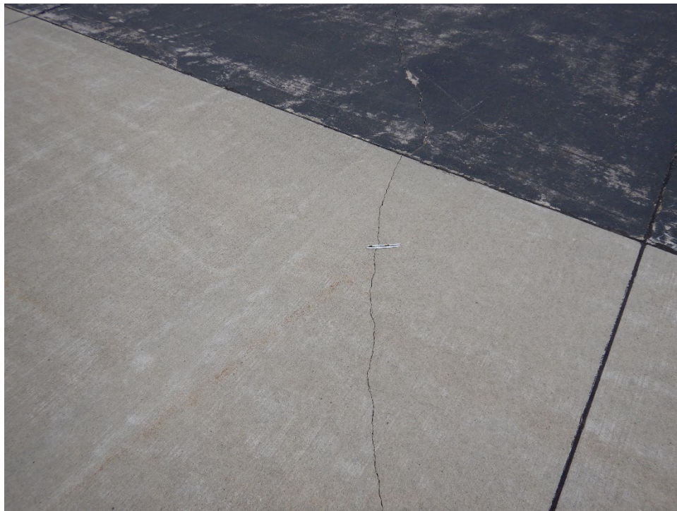
A02CN-01. Corner Break (Sample Unit No. 06).
