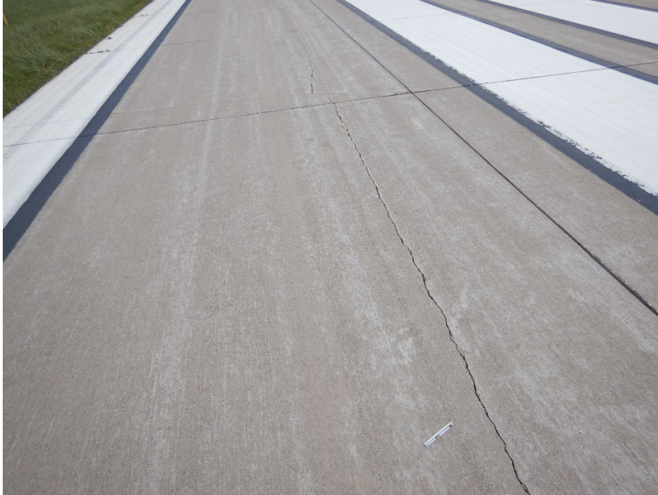
R03CN-01. LTD Cracking (Sample Unit No. 44).
