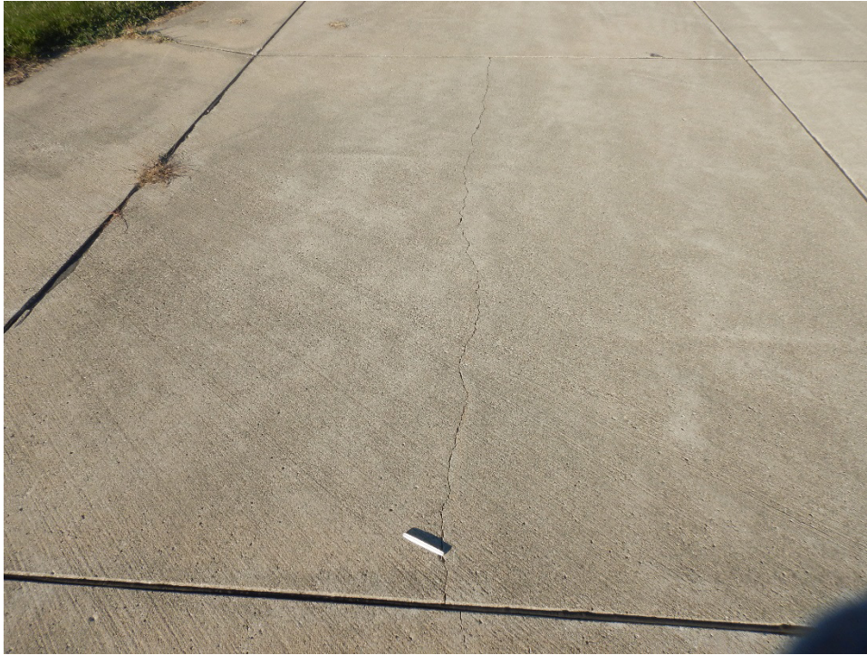
TAHA-01. LTD Cracking (Sample Unit No. 04).
