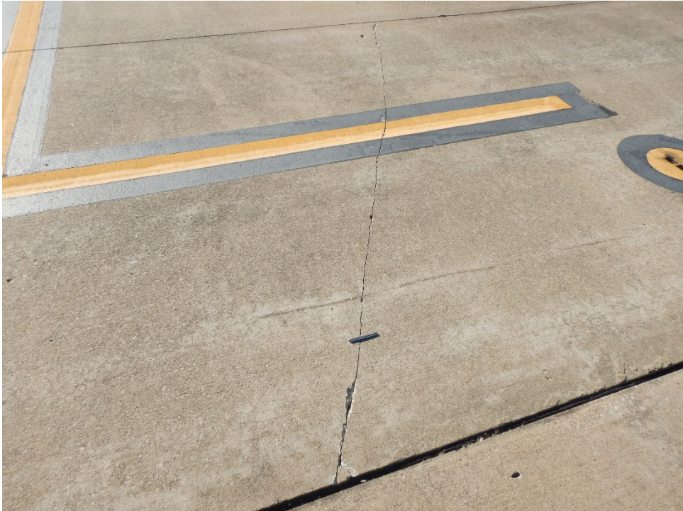
A01KE-01. LTD Cracking (Sample Unit No. 02).
