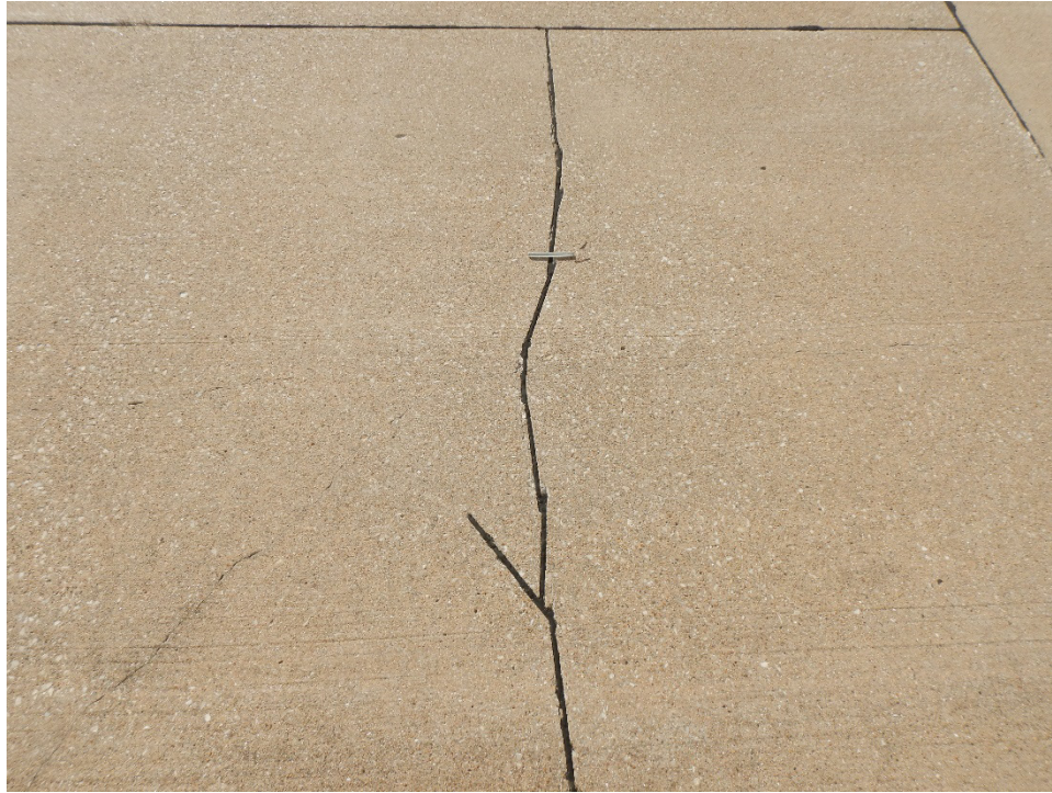
A01KE-03. LTD Cracking (Sample Unit No. 01).
