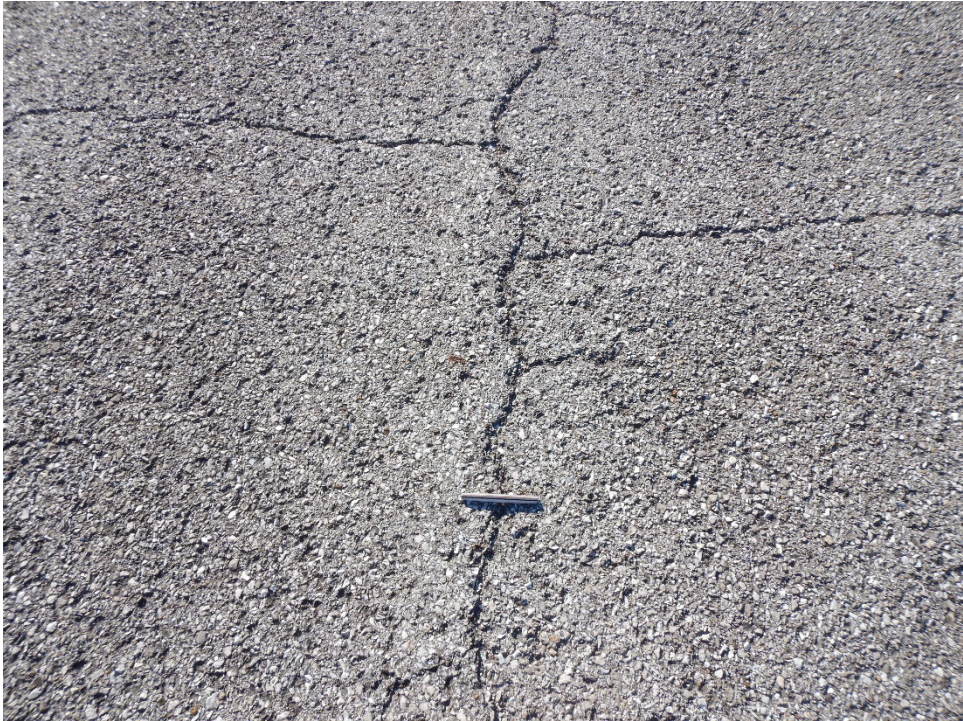
TEKE-01. L&T Cracking (Sample Unit No. 03).
