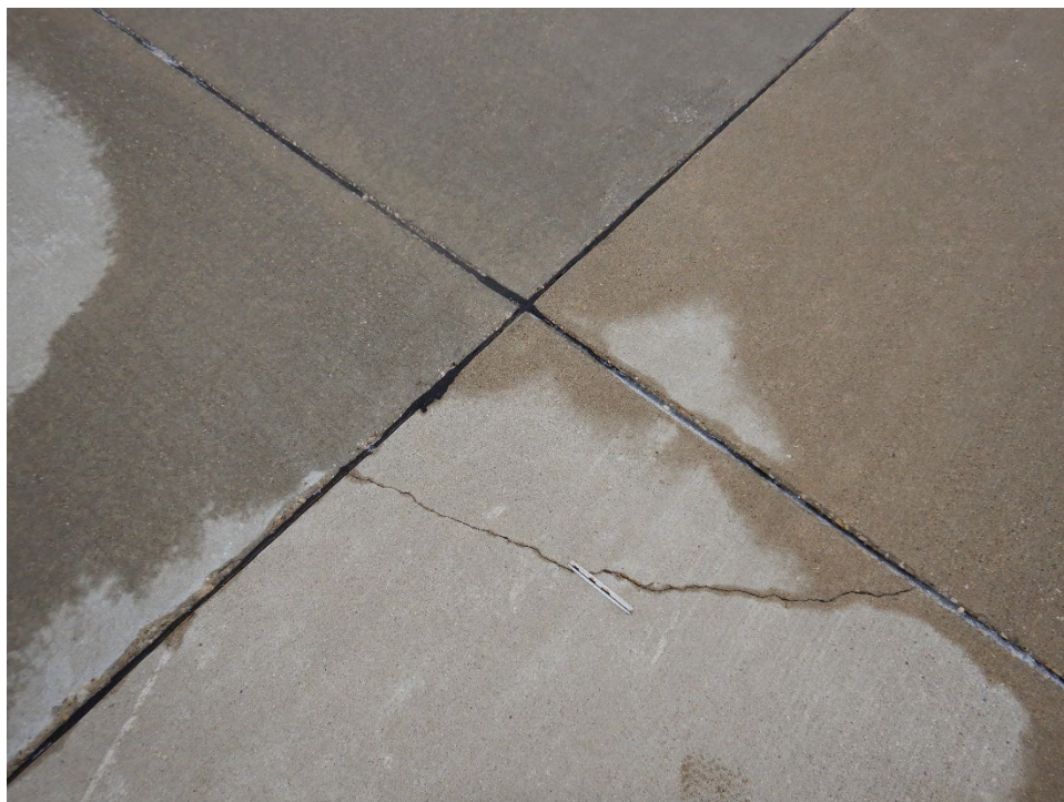
A03CC-01. Corner Break (Sample Unit No. 09).
