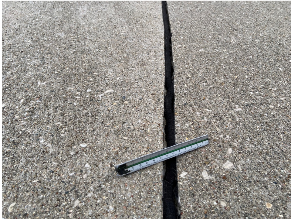
R17WU-01. LTD Cracking (Sample Unit No. 09).
