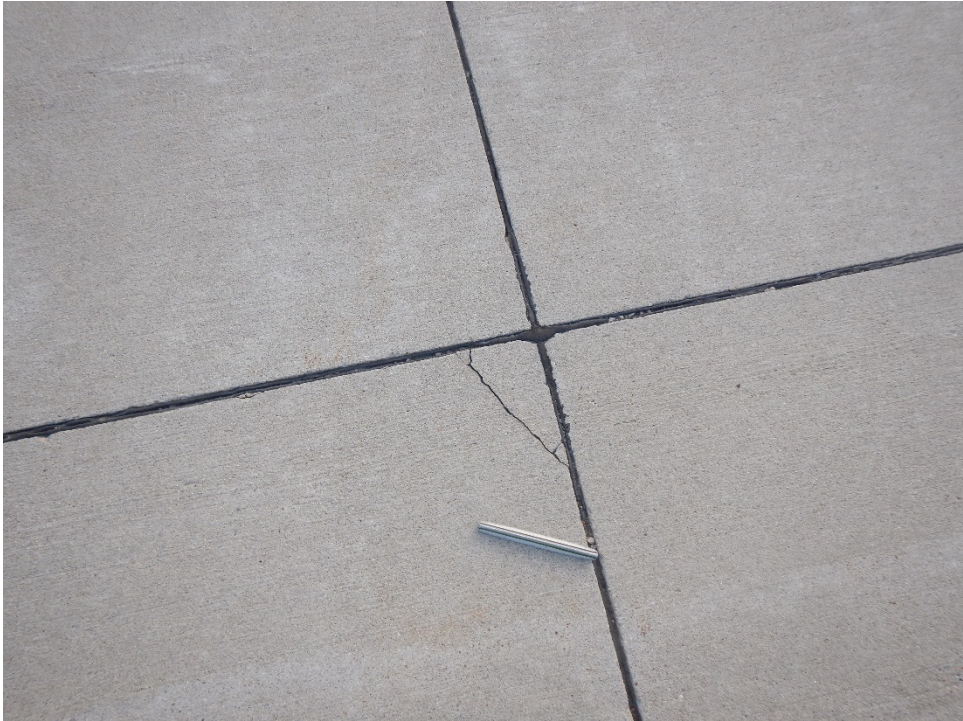
A01WU-05. Corner Spalling (Sample Unit No. 01).
