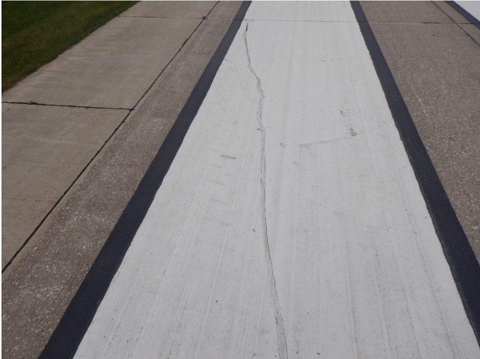
R17WU-02. LTD Cracking (Sample Unit No. 33).
