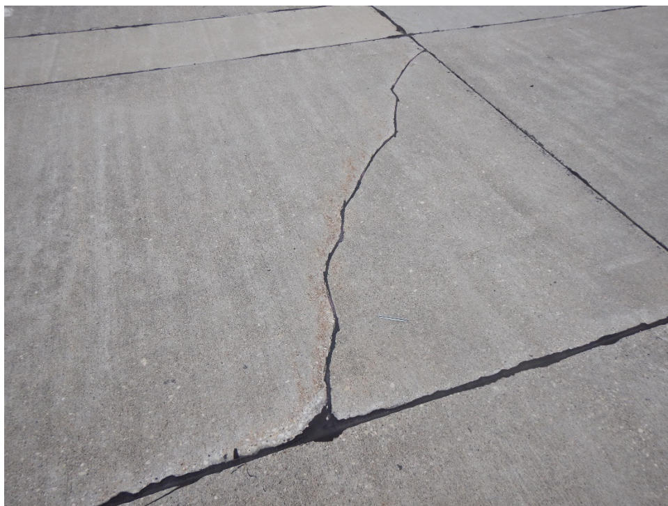
R17WU-01. LTD Cracking (Sample Unit No. 13).
